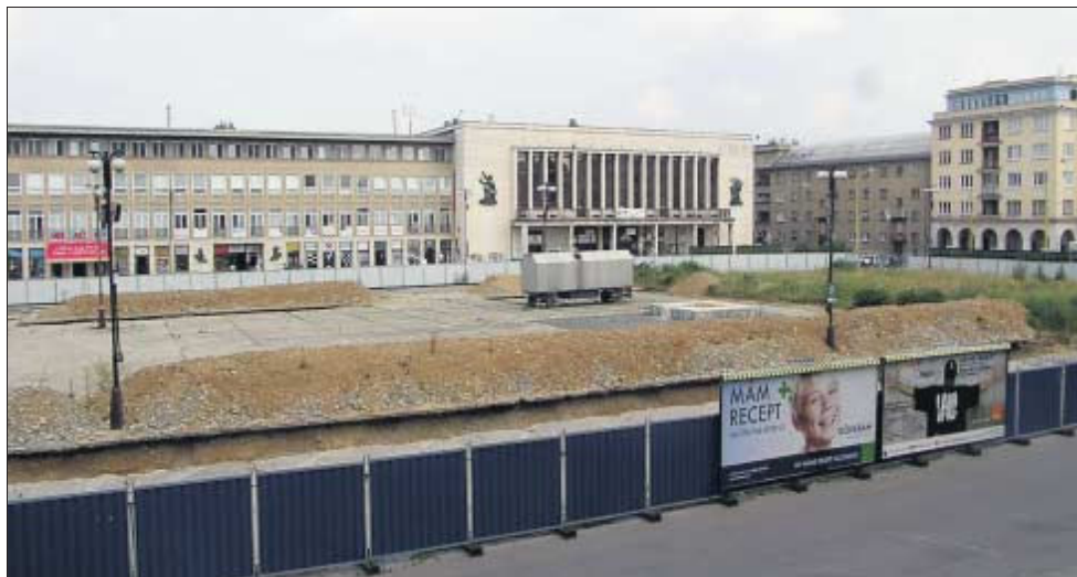
Výkop a oplotenie urobil investor bez stavebného povolenia, stavbu Auparku zastavil až súd. O proteste prokurátora proti stavbe by malo rozhodnúť ministerstvo výstavby.
